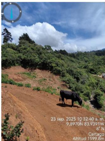
Se observan terrazas y caminos de construcción reciente, en el fondo de la propiedad, donde se presume que la pendiente original del terreno es bastante empinada y podría generar deslizamientos o taponamientos en la quebrada.
