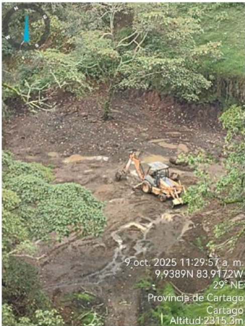
Foto 1. Terraza y maquinaria ubicada.
