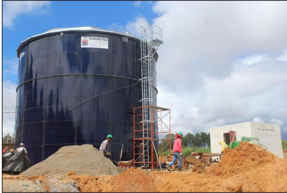
Imagen 15: tanque de almacenamiento de agua potable en el sector de Lourdes, distrito de San Francisco.
