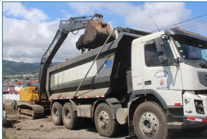
Imagen 13: atención de emergencias provocadas por las lluvias durante el 2024.
