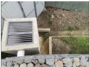
Fotografía 1Caja de Registro Principal
