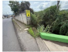
Fotografía No.4: Inexistencia de barreras de contención vehicular, km 1+820 LD
