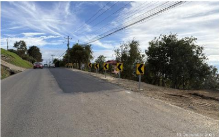
Fotografía No.4 Condición actual hundimiento Ruta Nacional No.218
