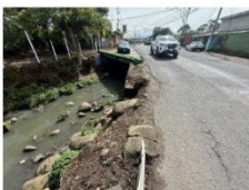
Fotografía No.2: Inexistencia de barreras de contención vehicular, km 1+785 LI
